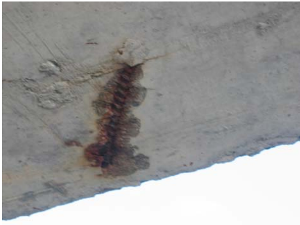
Avskalling som resultat av armeringskorrosjon
