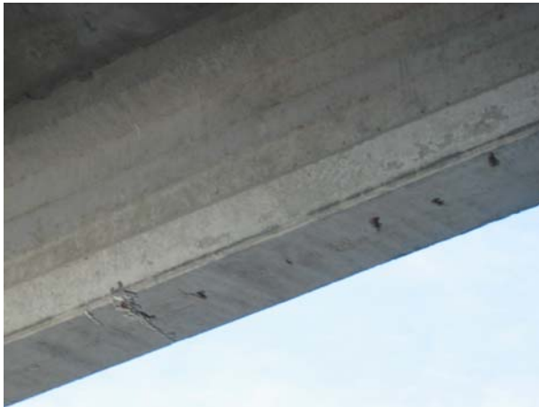
Begynnende armeringskorrosjon i underkant bjelke for skjærbøyler
