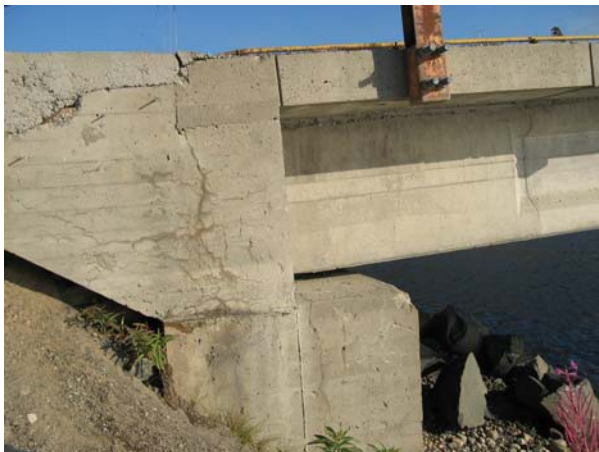
Krakelering av vinger og reparasjon av tidligere skade sannsynligvis fra påkjørsel på rekkverk.
