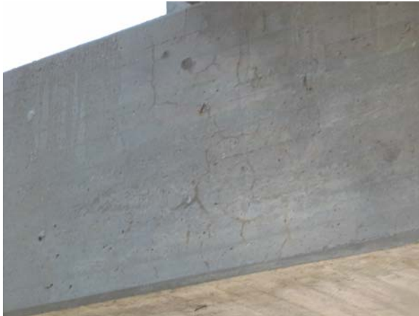
Krakelering av betongoverflate for tverrbjelke i søyleakse
