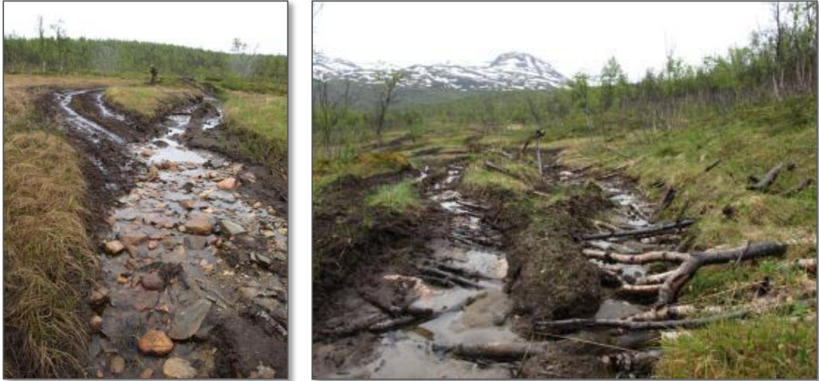
Figur 14. Eksempler på terrengskader og påfølgende erosjon i kjøretraséer i militært øvingsområde i indre Troms. (Foto: Anders Hammes).
