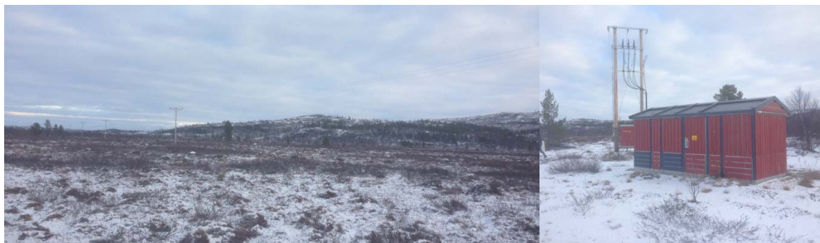
Figur 19 Høyspentledning langs varslingsområdet. Trafostasjon nær finskegrensen
