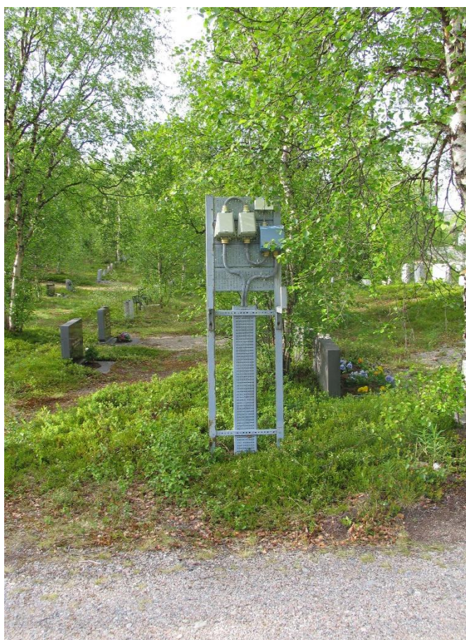
Fig. 23. Eksisterende strømuttak, nedre nivå. Innenfor utvidelsesområdet vil eksisterende uttak bli erstattet med strømuttakssøyler, jfr. tegning nr. LJ-013.
